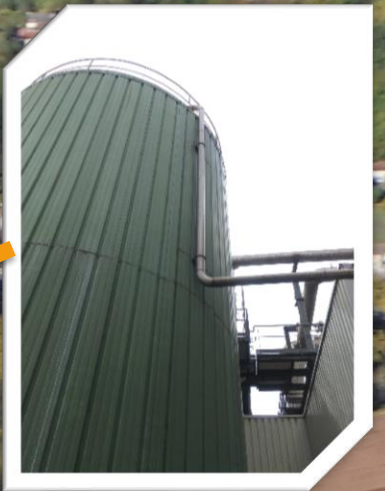
Stockage de chaleur
