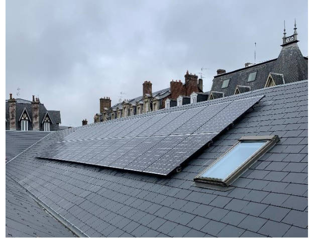
▲ Panneaux surimposés sur un toit
