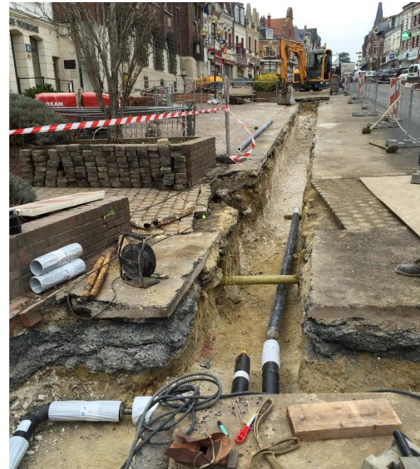
▲ Déploiement du réseau pour Alimenter la Mairie
