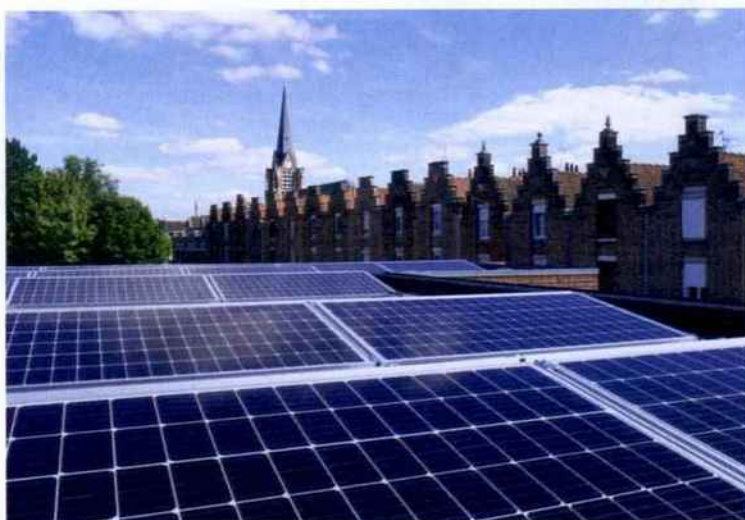
Panneaux solaires devant les corons.
