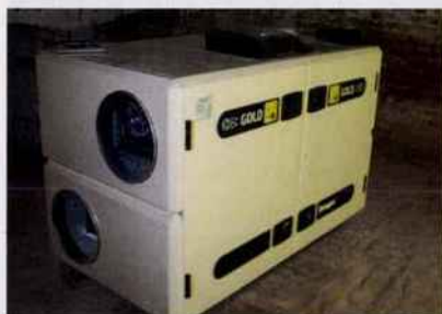
La double-flux installée dans la cave devenue local technique. Les échangeurs thermiques sont rotatifs.
