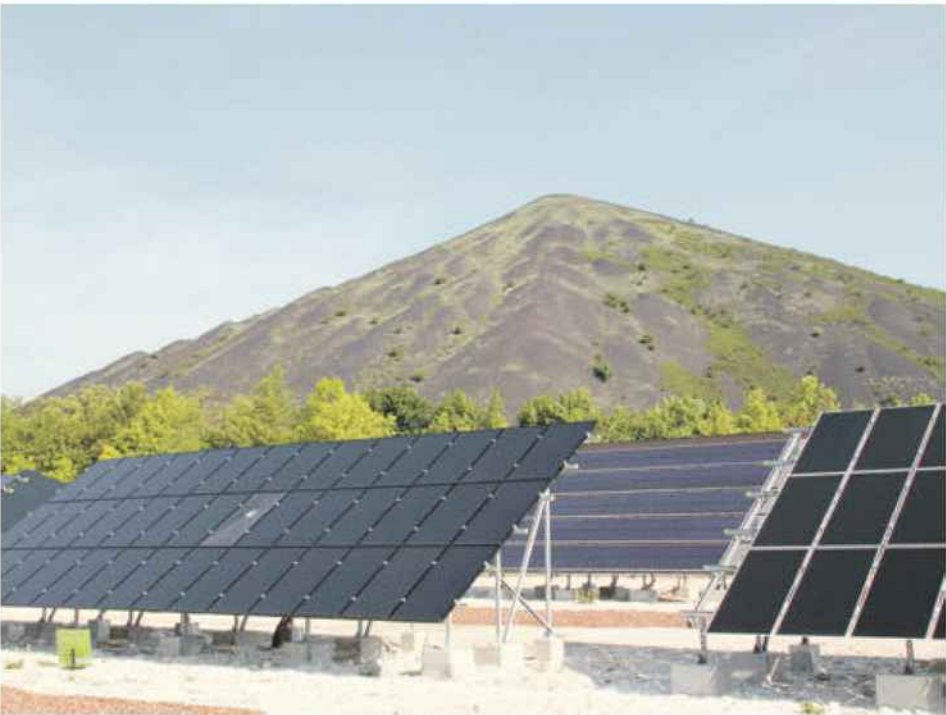
La plateforme Lumiwatt permet de procéder à des essais sur différentes technologies de panneaux.
