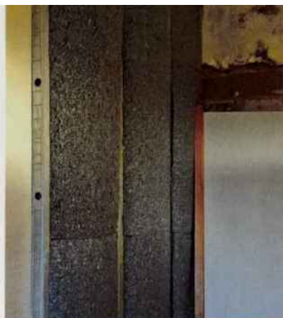
Isolation acoustique en Métisse entre les bureaux.
