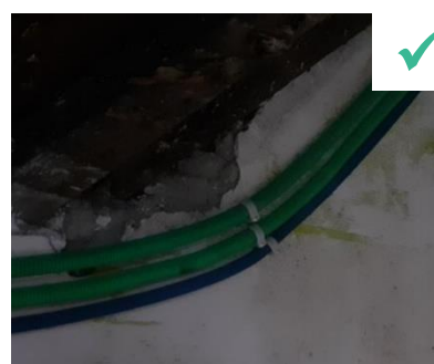
Fixer les réseaux techniques les uns à côté des autres pour mieux colmater la pénétration de la membrane.
