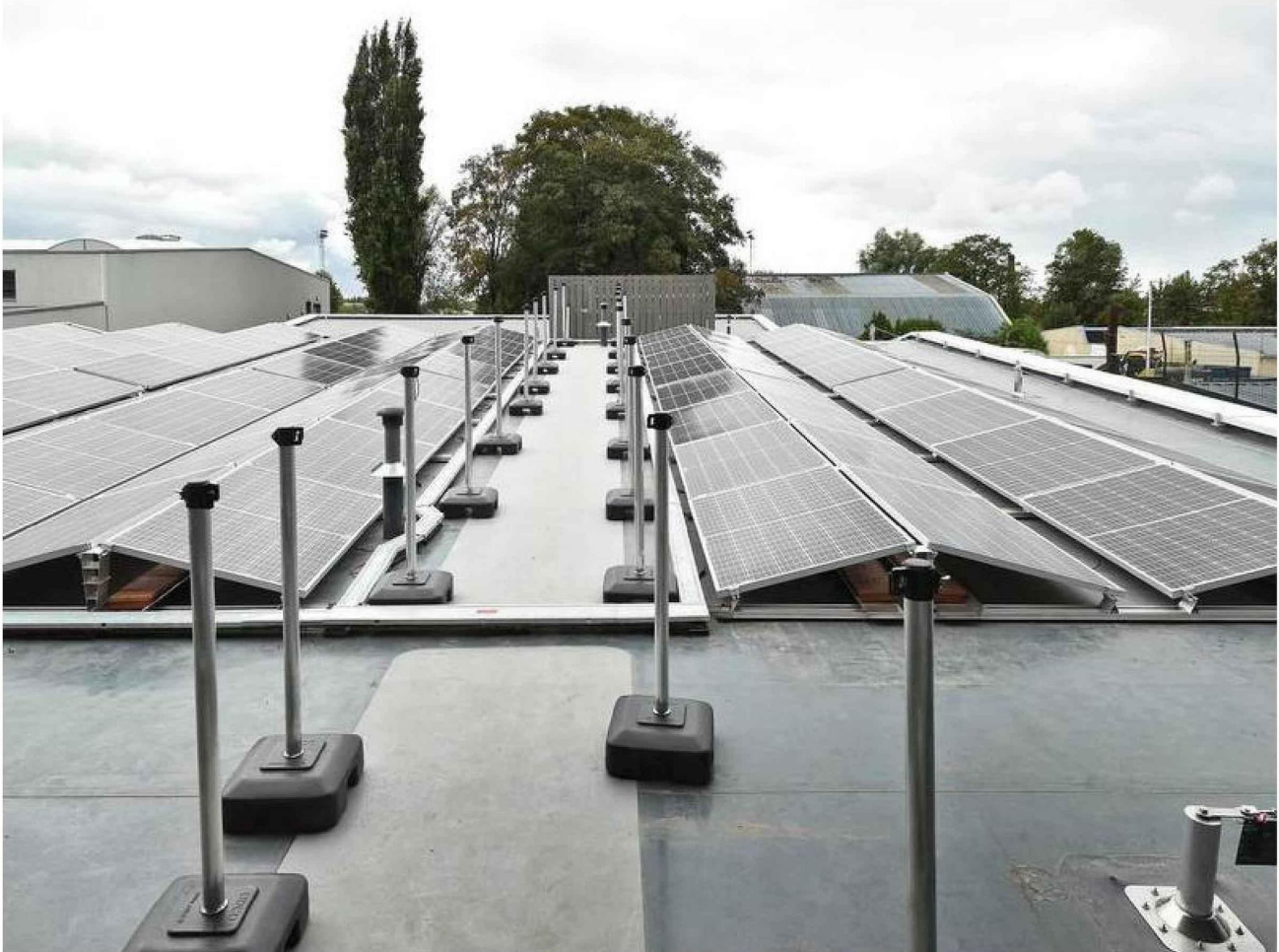
Des panneaux photovoltaïques sur les toits du groupe scolaire Crapet-Salengro, à Haubourdin. Pour les lycées en revanche, toujours rien de concret... PHOTO SÉBASTIEN JARRY
