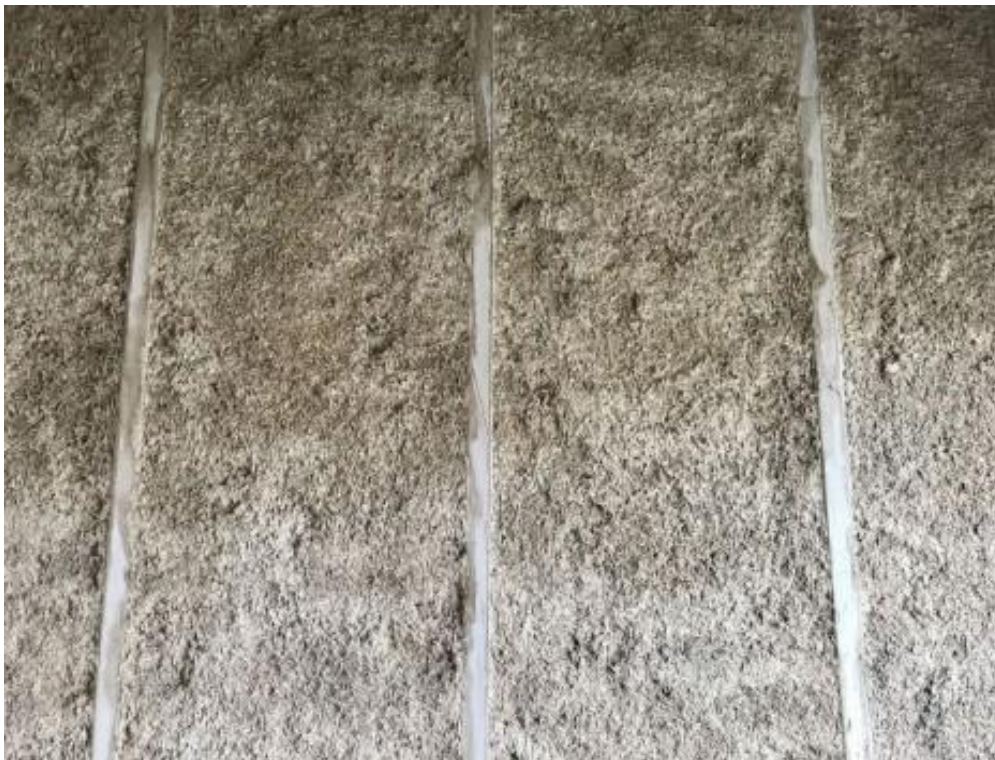
Du béton de chanvre projeté dans une maison de la cité Barrois, dans le département du Nord. © L-A Fournier
