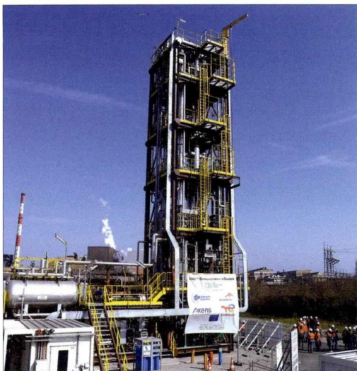
Ⓢ La tour de captation du CO 2 d'Arcelor.
