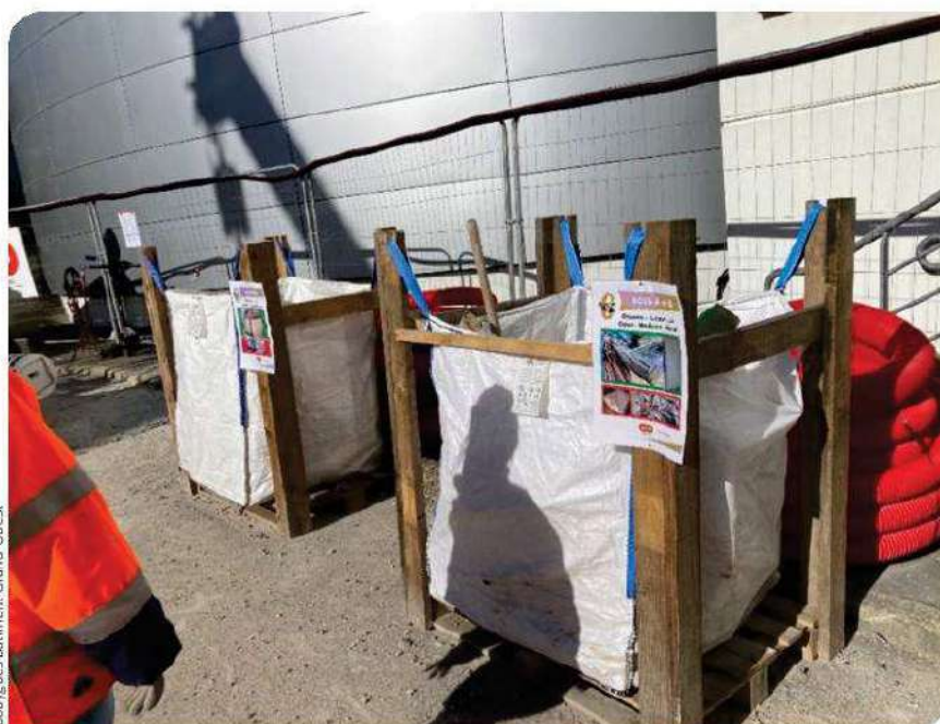
▲ Sur le chantier d'extension du CHU, Bouygues Bâtiment Grand-Ouest a installé une mini-déchetterie gérée avec Les Astelles, association d'insertion amiénoise qui œuvre dans le recyclage des déchets.
