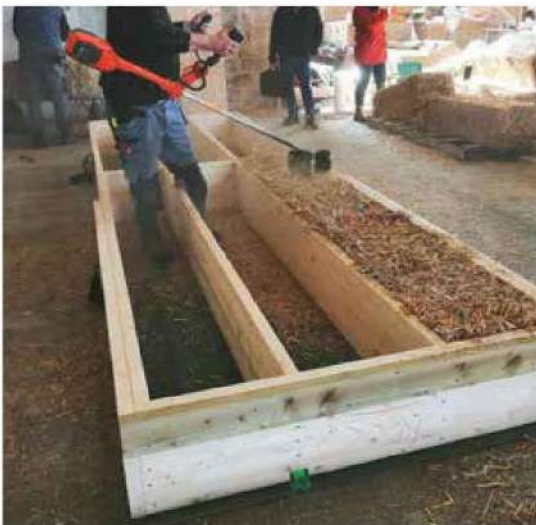
La paille, excellent isolant, est le plus souvent utilisée comme remplissage d'ossatures ou de caissons en bois.
