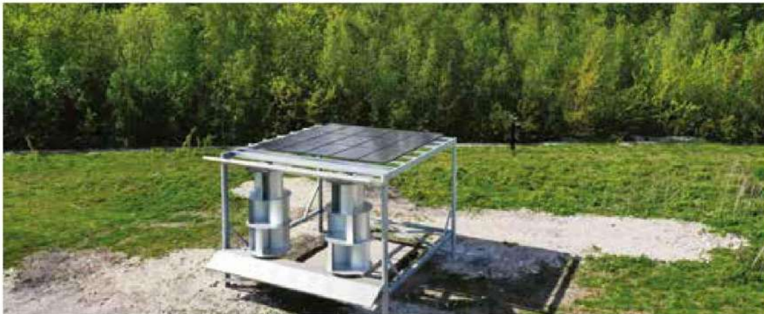
| Le démonstrateur d'éolienne urbaine d'Unéole, sur le site du cd2e , à Loos-en-Gohelle.
