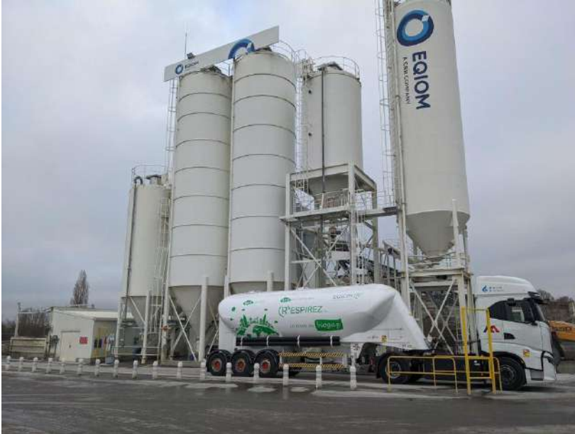
La centrale à béton Equiom. © K. S.
