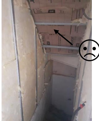
Le pare-vapeur doit être du côté chaud. Il devrait donc être au-dessus de l'isolant en sous-face d'escalier.
