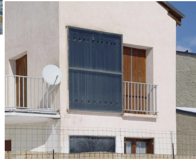
Mur capteur en circuit fermé
