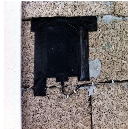
Capteur de flux et de température Côté bâtiment intérieur
