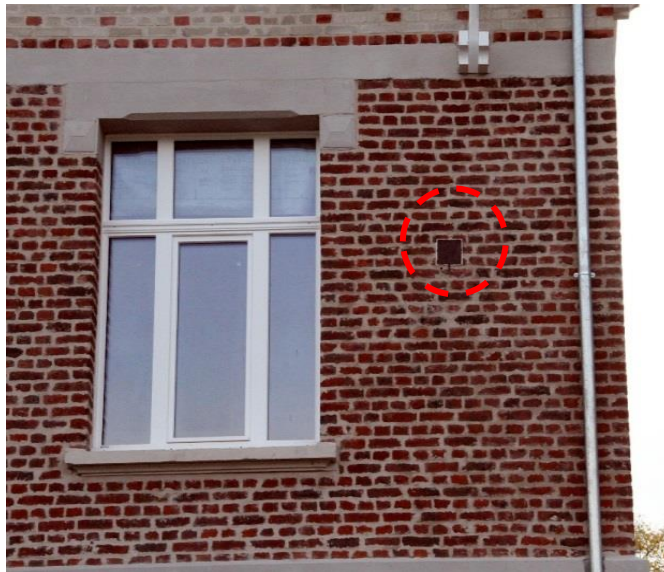
Capteur de flux et de température Mur extérieur
