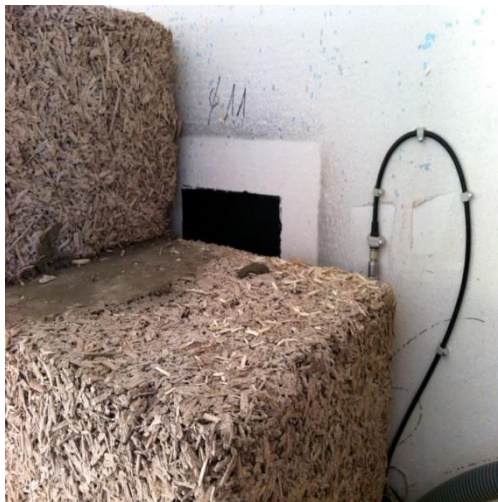
Capteur de flux et de température à l'interface mur-chanvribloc
