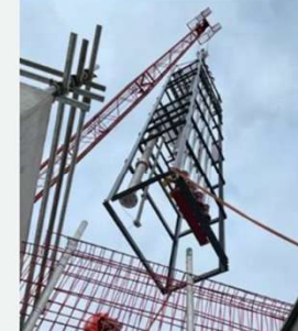
Gaines techniques préfabriquées
