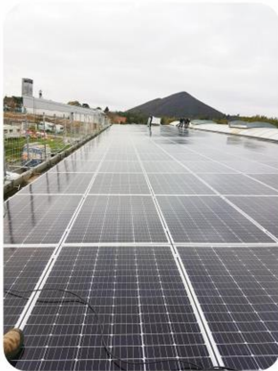
PV en toitures Loos-en-Gohelle (62) SAS Mine de Soleil
