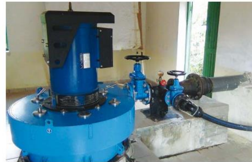
Turbine Pelton installée à Tolongoina
