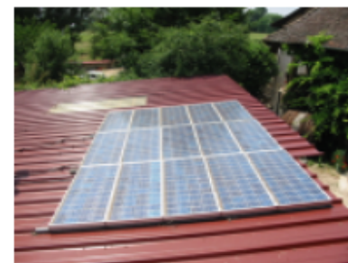
1992 : 1ère installation PV raccordée au réseau en France
